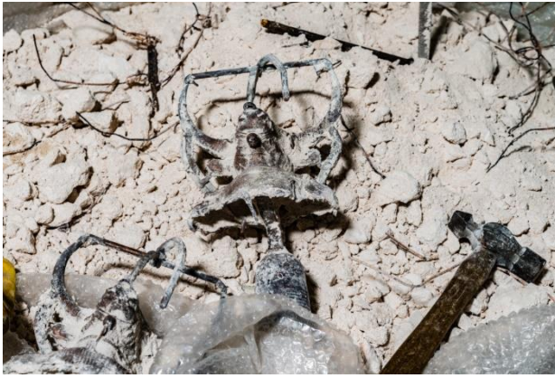
Foto: na het uitkappen is het gegoten beeld zichtbaar.
